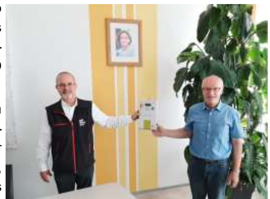
Konstantin deMartin Leiter des Netz NÖ Service Centers Klein Pöchlarn zeigt Bgm. Friedrich Fürst die neuen Smart Meter.
